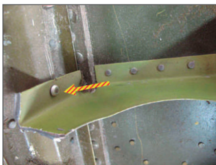
Figura 38 - Rebite inapropriado na estrutura metálica Fonte: Agência Força Aérea / © Cenipa.
